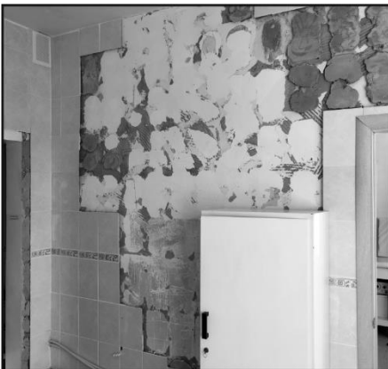
Рис. 9 б. Массовые отколы кафельной плитки
