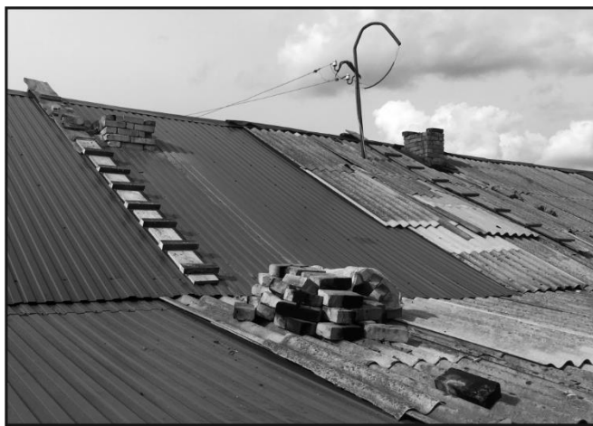
Рис. 10. Обвалившиеся печные трубы, пос. Орловка, ул. Катавская, д. 1
