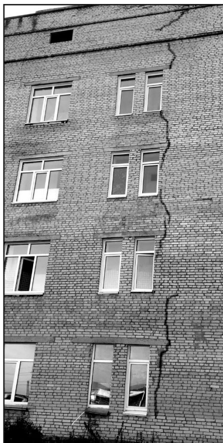
Рис. 9 в. Секущие трещины в несущей стене
