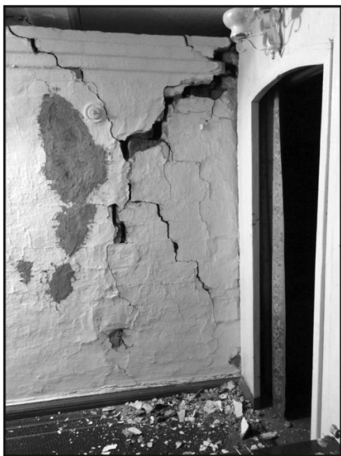
Рис. 8 а. Разрушенная печь в частном доме
