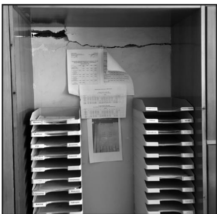
Рис. 9 а. Сквозные трещины во внутренних перегородках
