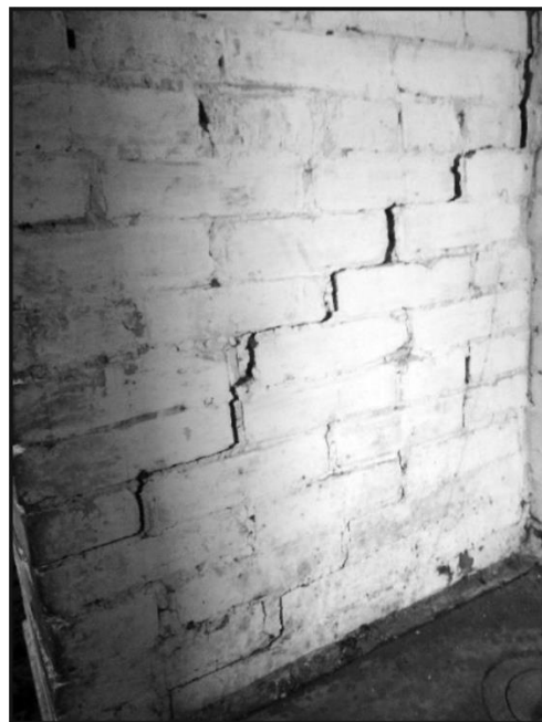
Рис. 8 б. Трещина в печи, ул. Герцена 1
