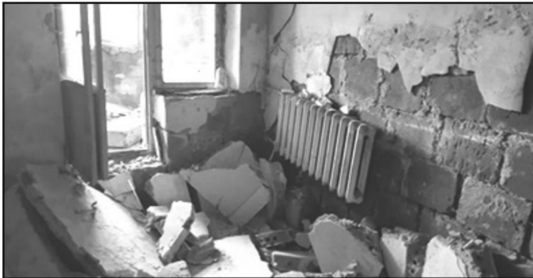
Рис. 5. Фрагмент поврежденного дома 4 разряда в г. Амасии
