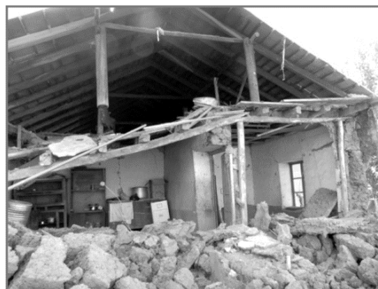
Рис. 4. Обрушение части крыши и стен жилого дома
