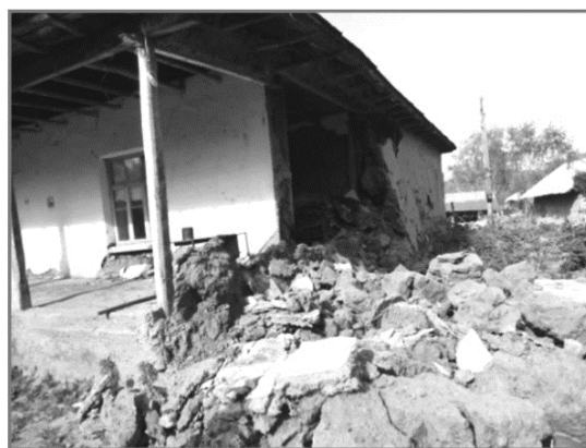
Рис. 2. Обрушение части стены жилого дома
