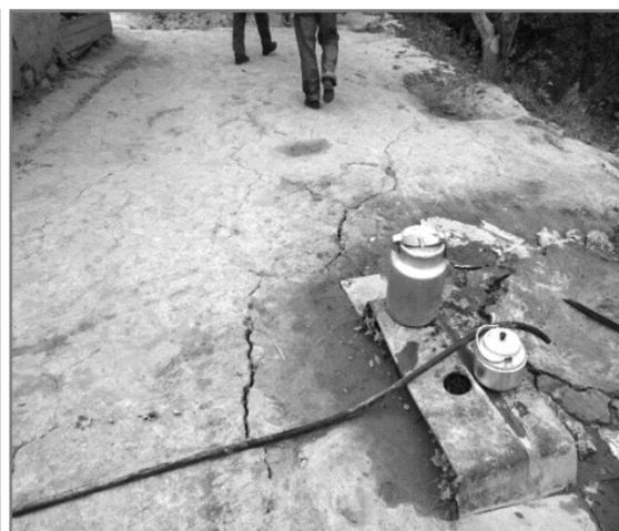
Рис. 6. Трещины на поверхности земли
