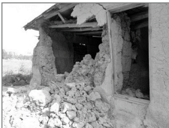
Рис. 3. Повреждение нового жилого дома
