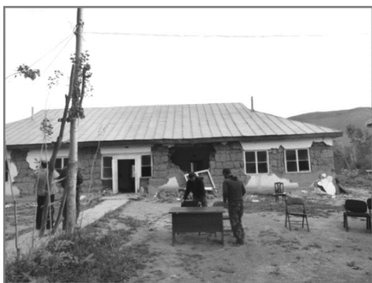
Рис. 1. Повреждение здания школы
