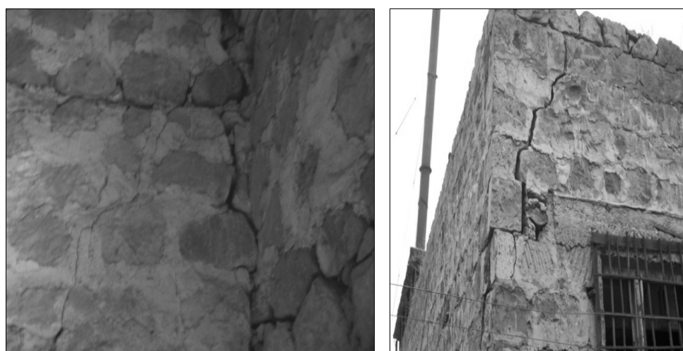
Рис. 3. Повреждения зданий Ахарскими землетрясениями 11.08.2012 г. на юге Республики Армения
