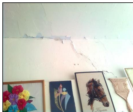
Рис. 7. Пос. Тымовское, на стене появились трещины, осыпание штукатурки со стен в одном из помещений школы
