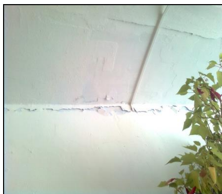
Рис. 6. Пос. Тымовское, раскрытие шва между стеной и потолком в классной комнате здания школы
