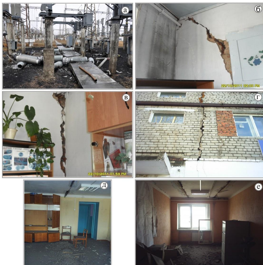
Рис. 4. Примеры повреждений, вызванных Сковородинским землетрясением 14 октября 2011 г.
