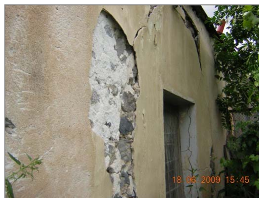
Рис. 4. Пример разваленной штукатурки на внешней стене здания в пос. Гарни ( \Delta=9 км) из [9]
