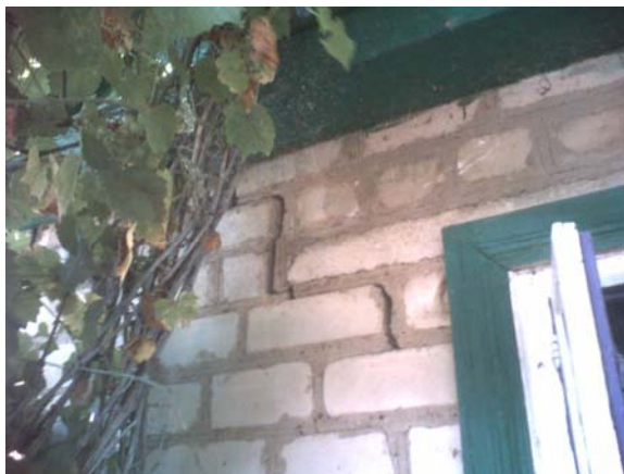
Рис. 10. Трещины в стенах снаружи дома в ст. Суворовская, на ул. Октябрьская, 107
