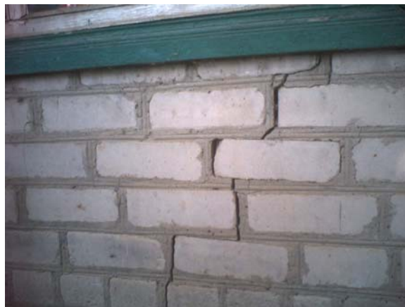
Рис. 11. Трещины снаружи флигеля в ст. Суворовская, на ул. Октябрьская, 107
