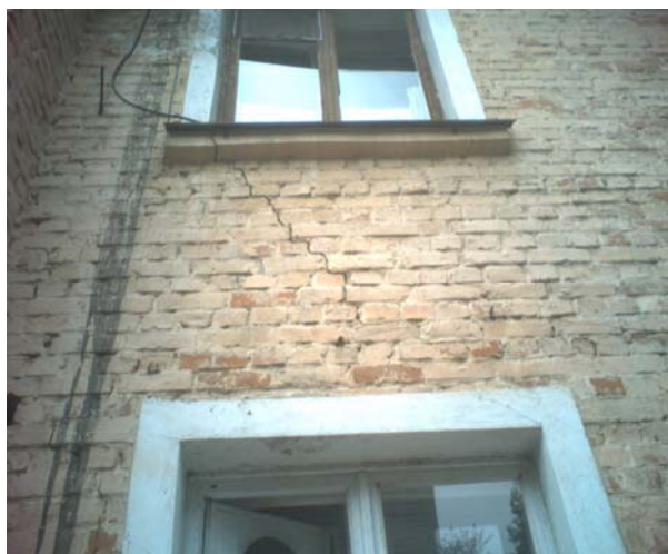
Рис. 12. Диагональная трещина от окна вниз, дом по ул. Энгельса, д. 32 а
