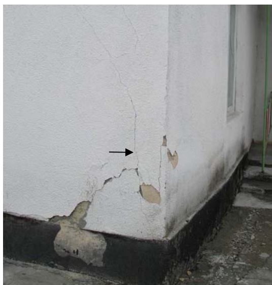
Рис. 4. Пгт Кольчино, ул. Фридяшивская, 82, здание детского сада (трещины в штукатурке)
