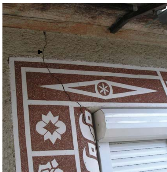
Рис. 5. Пгт Кольчино, ул. Шелестивская, 215 (трещины в штукатурке)
