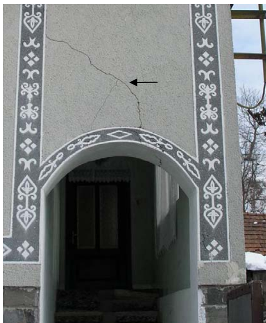
Рис. 8. Пгт Клиновец, ул. Молодежная, 40 (трещины в арке и над аркой при входе в дом)
