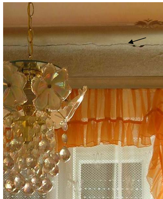
Рис. 9. Пос Клиновец, ул. Молодежная, 47 (трещины в штукатурке на стыке стен и потолка)
