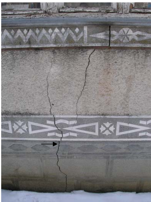
Рис. 6. Пгт Кольчино, ул. Шелестивская, 211 (трещины в штукатурке стены и фундамента)
