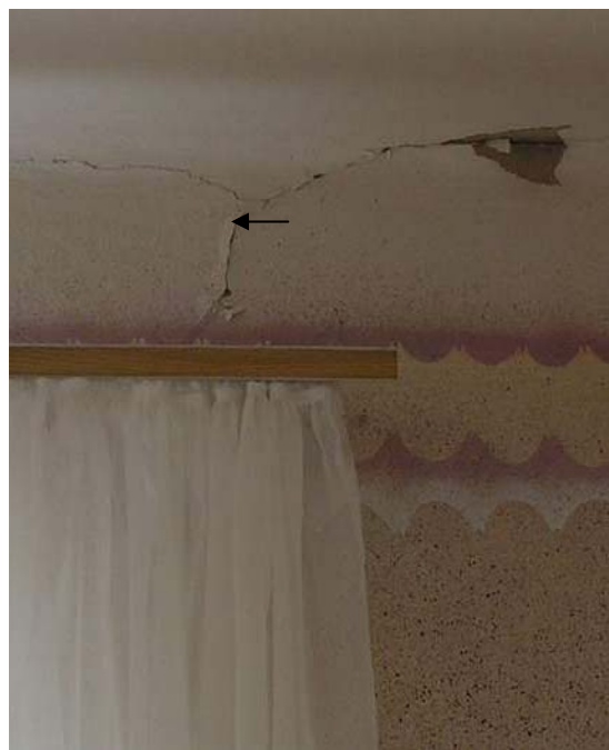
Рис. 7. Пгт Клиновец, ул. Молодежная, 40 (трещины в штукатурке на стыке стен и потолка)
