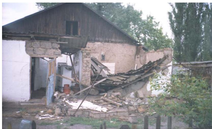
Рис. 4. Обрушение стены дома на станции Луговая
