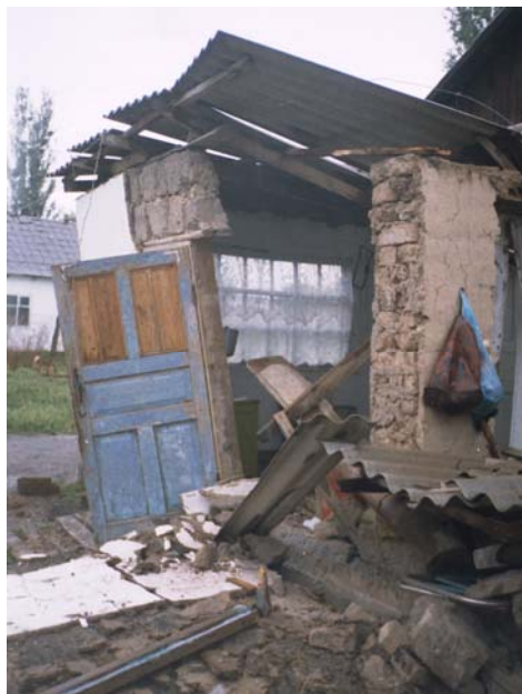
Рис. 3. Разрушение части жилого дома на станции Луговая
