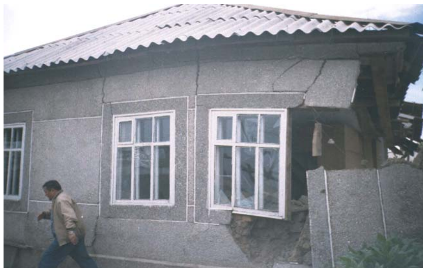
Рис. 2. Обрушение угловой части жилого дома на станции Луговая
