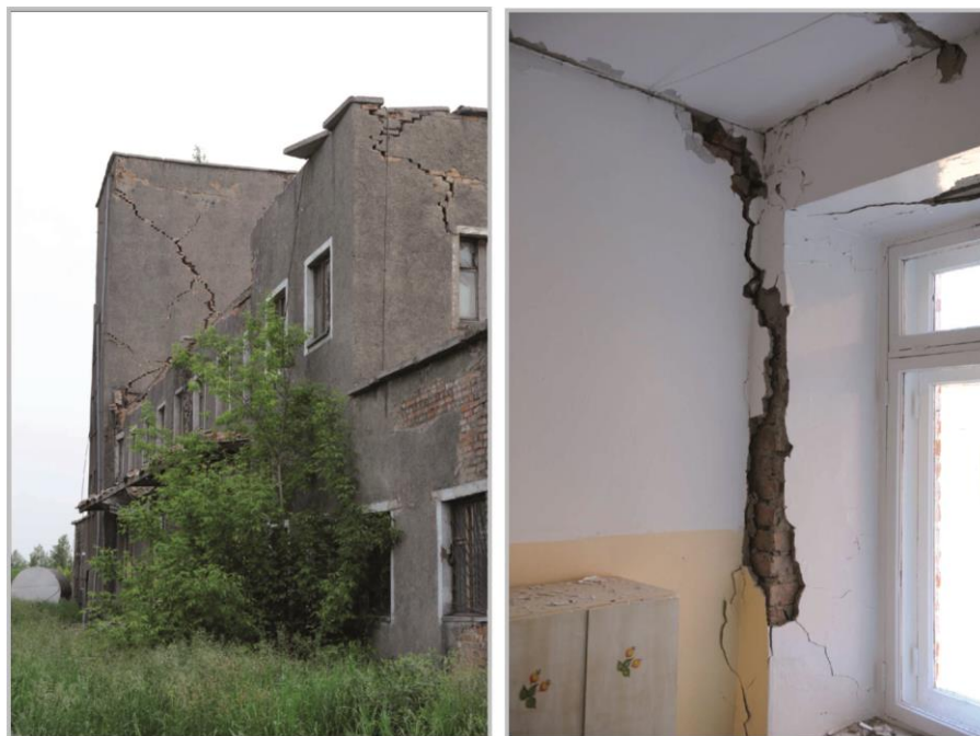
Рис. III.25. Разрушения при Бачатском землетрясении 2013 г. (пос. Бачатский, 4 км от эпицентра)
