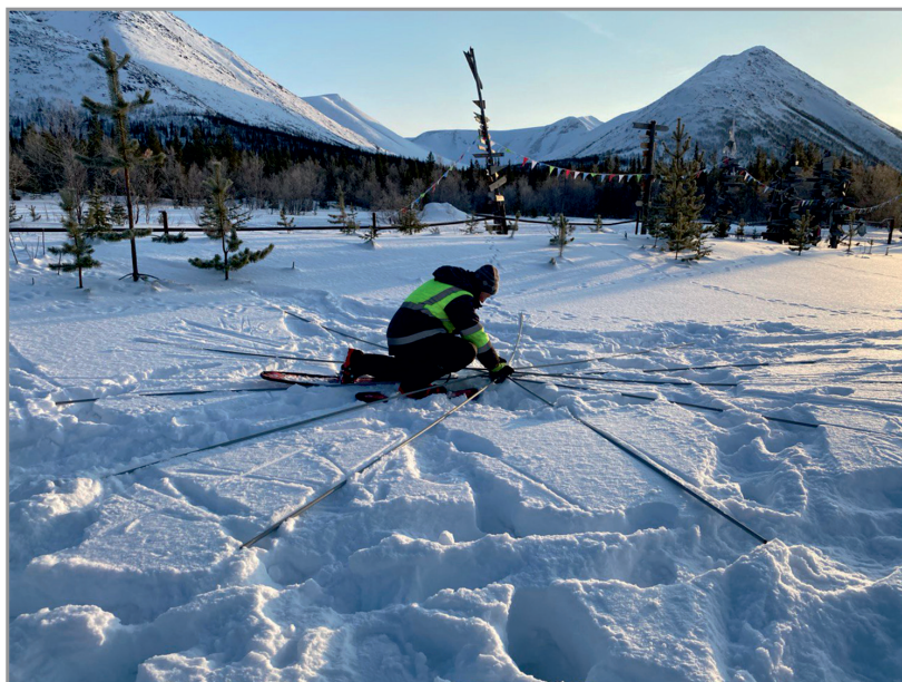
Рис. 3. Монтаж пространственного фильтра низких частот на одном из микрофонов сейсмоинфразвукового комплекса KLPR
