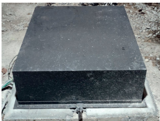
Рис. 10. Оборудование станции, укрытое утеплённым металлическим коробом, 2023 г.
