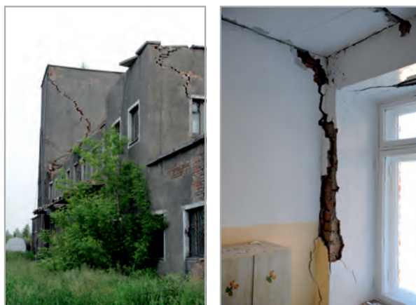
Рис. 9. Разрушения зданий при Бачатском землетрясении
